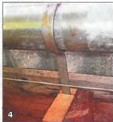
Плечо кронштейна надежно зажато между «половинками» накладки
