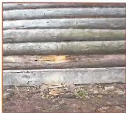
Северная стена дома. Продольное бревно закладного венца сруба требует срочной замены
